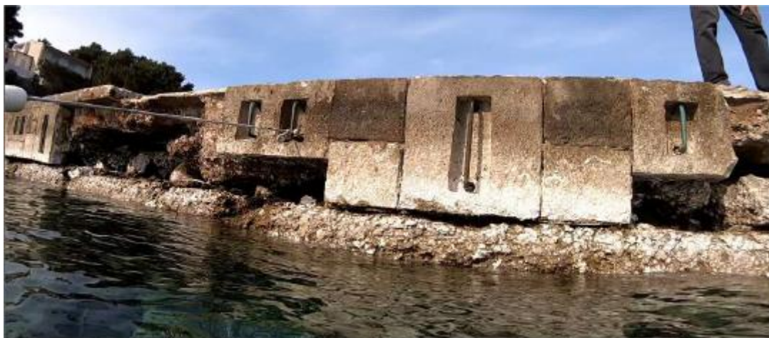
Slika br. 5: Oštećenja na unutrašnjem gatu
